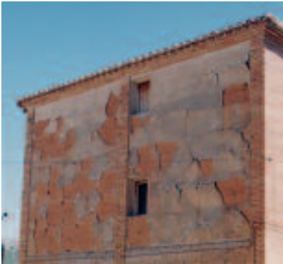
Figura 4. Fenomeno di distacco del rivestimento in un paramento di terra rinforzata con gesso dovuto all'impiego del cemento nell'intonaco, Torrebaja (Valencia) (foto degli autori).
