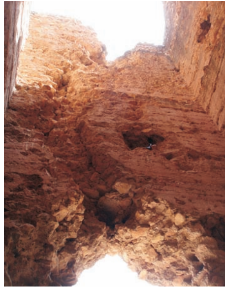
29. Derrumbe parcial de toda una franja vertical de tapia interior desde la brecha de acceso hasta la coronación (fotografía: Mileto & Vegas)
