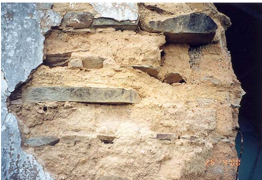
Fig.14 – Taipa com pedra no meio das fiadas na Casa Escola, em Ermidas de Sado, Concelho de Santiago de Cacém.
