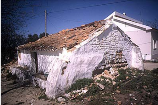
Fig.12 – Habitação em adobe, caiada a branco, com poial e gigantes (contrafortes) em pedra.
